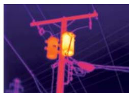
Перегретый полюс трансформатора
